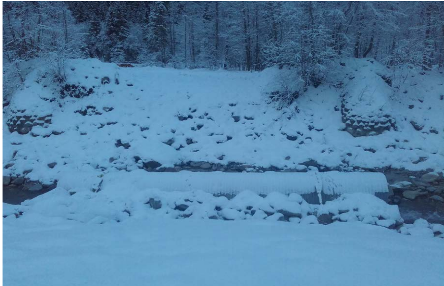
Abb. 18 Stahlrohr L ca. 5 m, welches bisher mit Schnee von der Strassenräumung überdeckt wurde (wird in Zukunft analog Anhang A ausgeführt)
